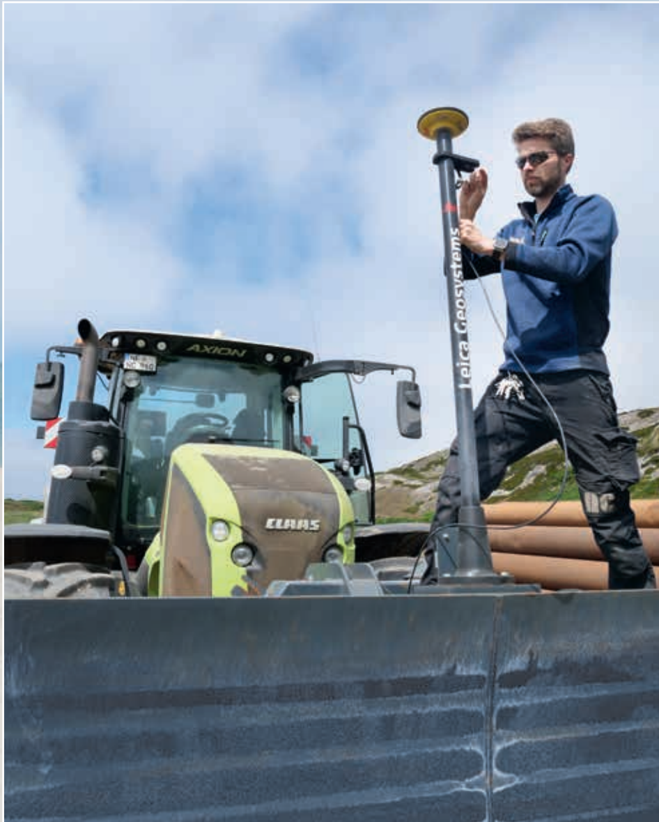
Die GPS-Empfangsantennen für die automatische Höheneinstellung werden am Frontschild und am Schürfkübel angebracht.
