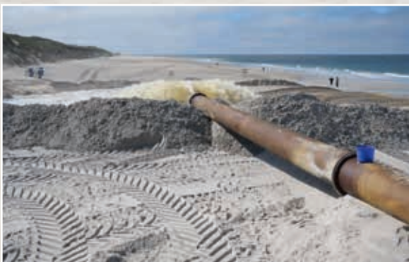
Volles Rohr: Der fehlende Sand wird per Schiff vom Meeresboden gesaugt und über eine aufwendige Rohrverbindung an den Strand gespült.
