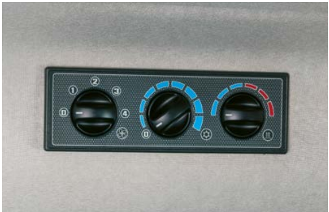
La commande du système de ventilation est parfaitement accessible sur le côté droit du pavillon de la cabine.
