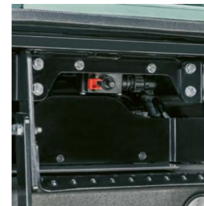
O disjuntor da bateria encontra-se à mão, na entrada esquerda.
