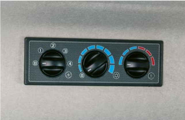
Upravljačke jedinice ventilacijskog sustava lako su dostupne s desne strane krovne obloge.
